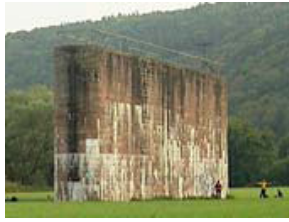
Ruine der Strecke 46: Brückenpfeiler als Kletterwand.
